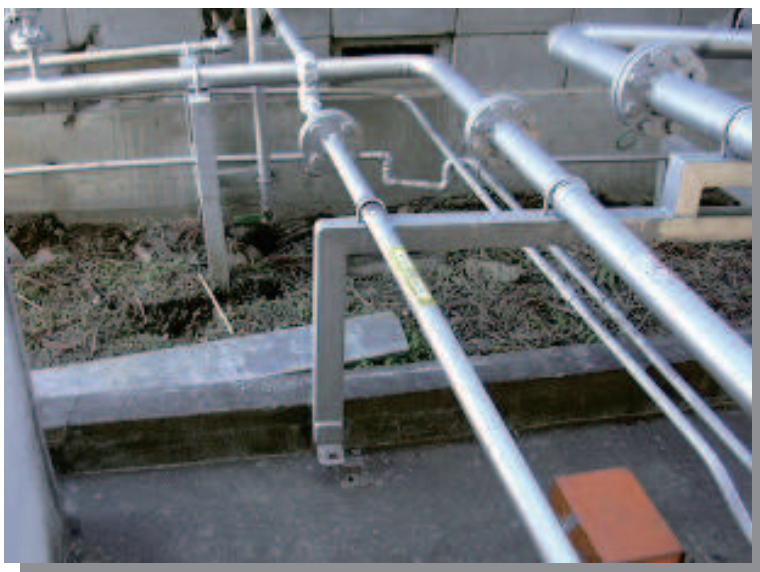
13.4 配管系の架台のアンカーボルトが離脱
