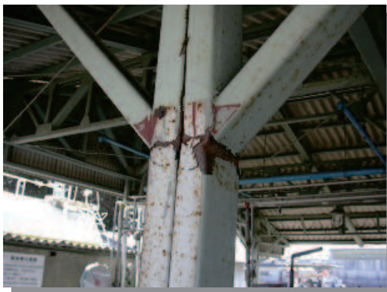
13.5 建屋柱（ライトゲージ）の破損
