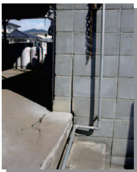
13.6 建屋の床及び壁（ブロック壁）の亀裂
