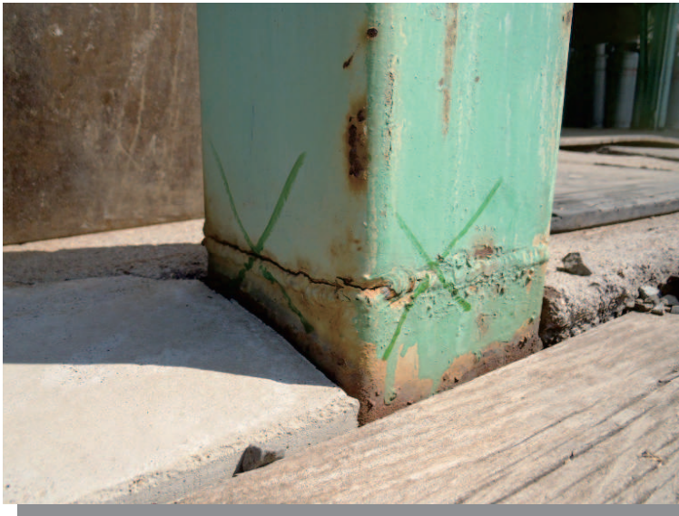
13.7 充填所支柱溶接部の亀裂
